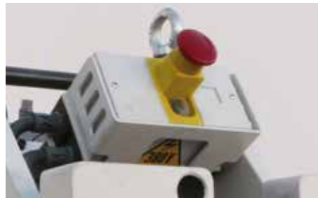
Boîte électrique avec bobine et protection moteur. Schaltkasten mit Spule und Motorschutz.
