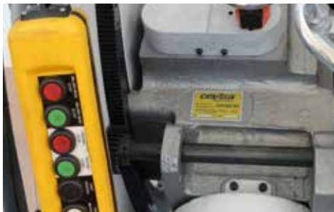
Commandes de contrôle. Kontroll-Knopfleiste.
